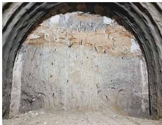
8. Il fronte di scavo in sezione consolidata dall'alto con pali plastici (intervento al fronte 36VTR semplicemente cementati)
