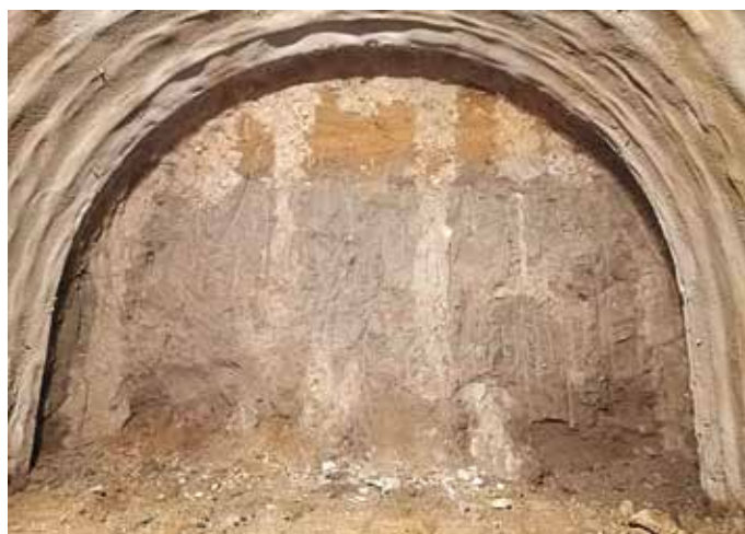
9. Il fronte di scavo in sezione consolidata dall'alto con jet grouting (nessun ulteriore intervento di consolidamento al fronte)
